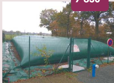
Réserve Incendie (ZA la Bruère)
